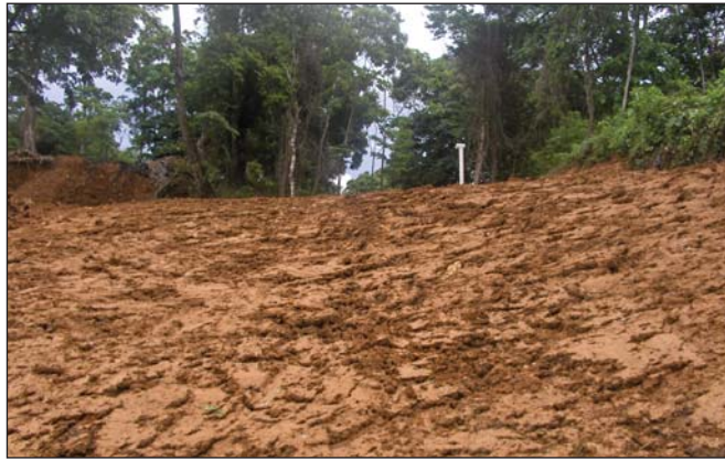
Chimenea para evacuar el gas metano y el dióxido de carbono en el vertedero controlado de Isla Colón, Bocas del Toro. Julio 2005
